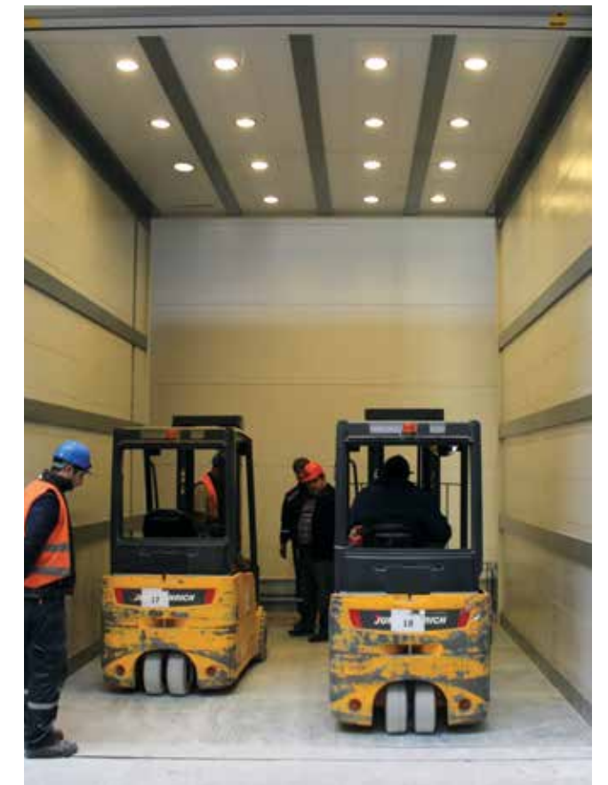
Hydraulic lift (rated load 10.000 kg) Гидравлический лифт (грузоподъемность 10.000 кг)
