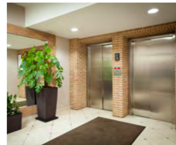
2 электрических пассажирских лифта
